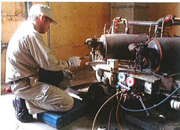
《冷媒フロンの漏えい点検作業》
